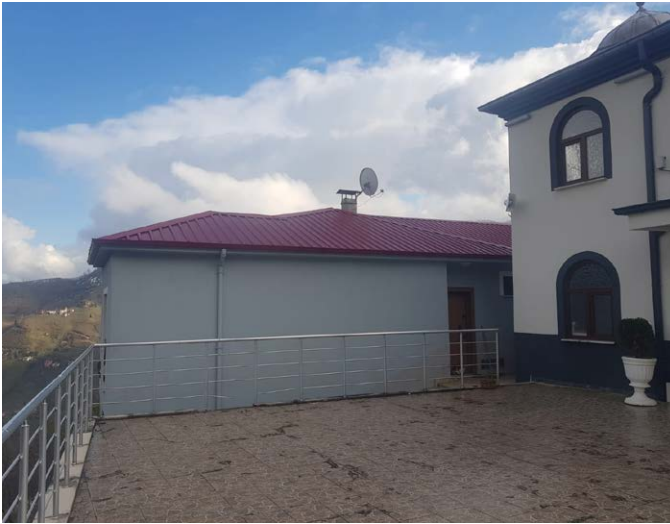
Pınarlı Mahallesi'nde mahalle sakinleri tarafından yenilenen imam evi için eski imam evinin yıkım ve hafriyata kaldırma işlemleri yapıldı. Ayrıca imam evi inşaatına beton desteği verildi.
