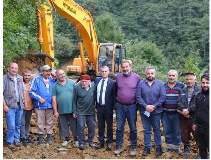
Ocak Mahallesi Merkez Mevkii ile Kıratlı Mahallesi Firincit Mevkii arasındaki yolda yol genişlemesi yapıldı.
