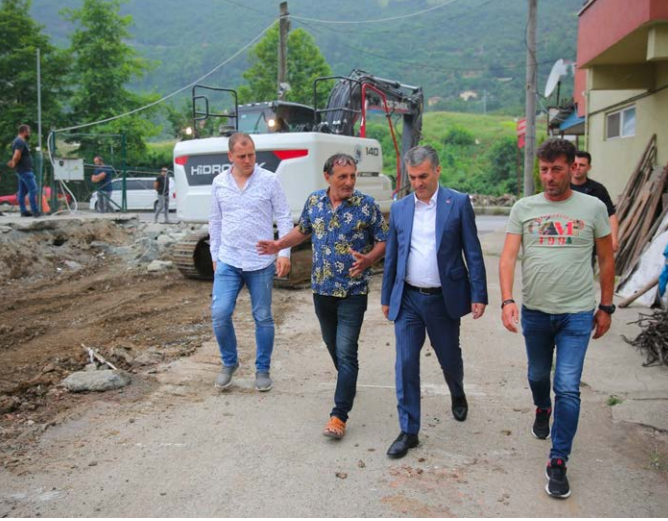
Namikkemal Mahallesi'nde imar yolları açıldı. Bu kapsamda imar yolları güzergâhlarında bulunan izinsiz yapılar yıkıldı.
