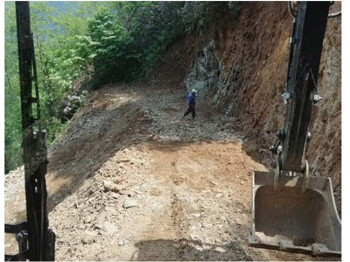
Gülyurdu Mahallesi Samara Alt Cadde ve Kabelet mevkilerinde muhtelif noktalarda yol betonlaması yapıldı.
