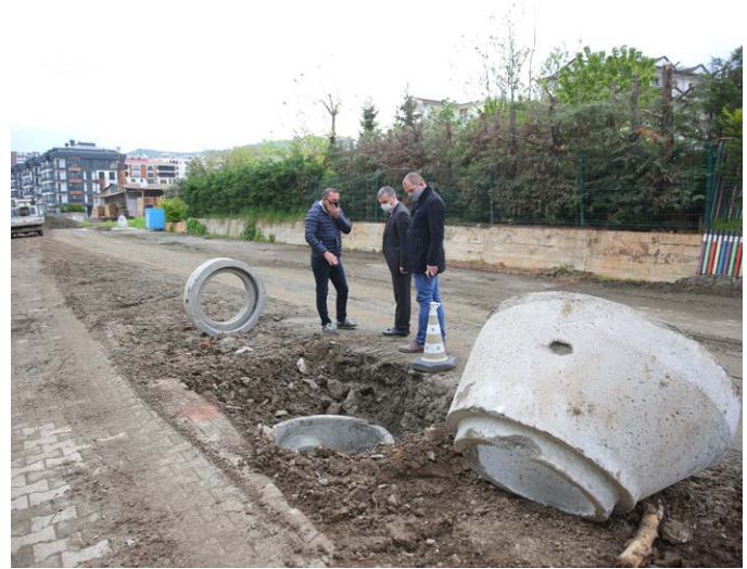
Kaşüstü Mahallesi Merkez Caddesi, Bekirbaşıoğlu Sokak, Villalar bölgesi, Merkez caddesi ve Seyrantepe Sokak arasında kalan alanda ve bazı muhtelif sokaklarda yağmur suyu hatları inşa edildi. Böylece bölgede yaşanan su taşkınlarının önüne geçildi.
