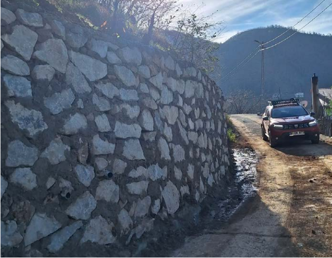
Taşdelen Mahallesi Avcioğlu Ruşenler Mevkii'nde istinat duvarı ve açık kanal imalatı yapıldı.
