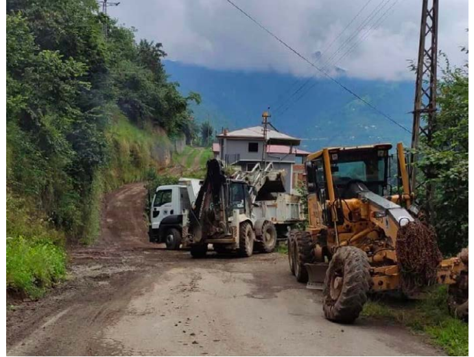
Tepeköy Mahallesi'nde 15 farklı noktada yollardaki dere geçişlerine büz ve boru konularak altyapı çalışması yapıldı. Tepeköy Mahallesi'nde çöp konteynırları yenilendi.
