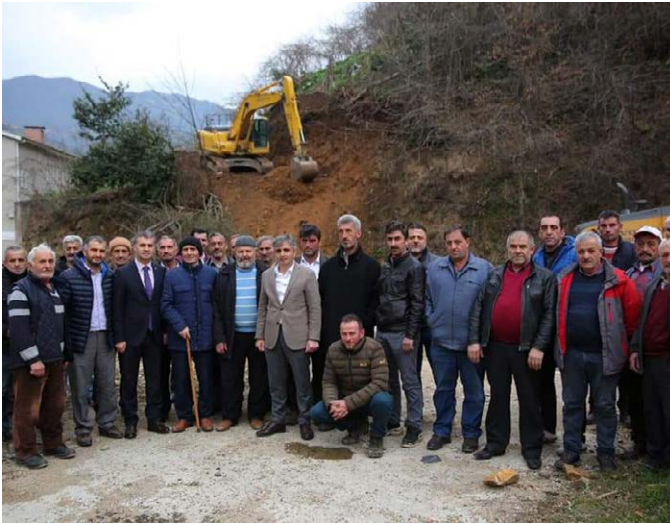
Oymalı Mahallesi Kazantaş Mevkii'nde 2 km, Cumhuriyet Mevkii'nde 2 km olmak üzere toplam 4 km yeni yol açıldı. Kazantaş Mevkii'nde yol genişlemesi yapıldı.
