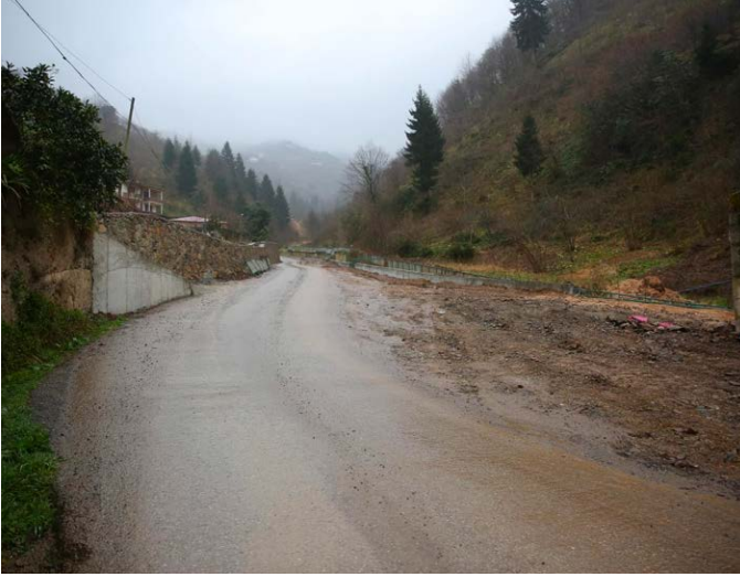
Kömürcü Mahallesi Kozdeğirmen Mevkii'nde Trabzon Büyükşehir Belediyesi ortak çalışma yaparak, metruk bina yıkıldı, yol genişlemesi ve istinat duvarı yapıldı.
