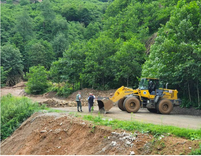
Ocak Mahallesi'nde sel ve heyelan nedeniyle hasar gören menfezler düzeltildi.
