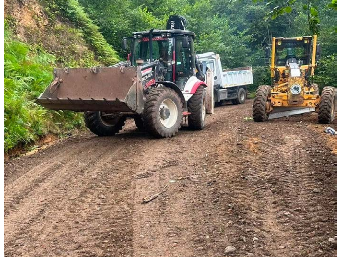
Kömürcü Mahallesi'nde 20 farklı noktada yollardaki dere geçişlerine büz ve boru konularak altyapı çalışması yapıldı. Kömürcü Mahallesi'nde çöp konteynırları yenilendi.
