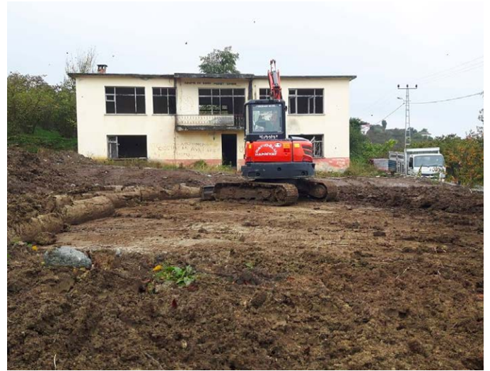
Namikkemal Mahallesi'nde önceki dönemlerde hafriyat ve atık döküm alanı olarak kullanılan eski ilkokul bahçesi ve çevresinde bulunan hafriyatlar kaldırıldı.
