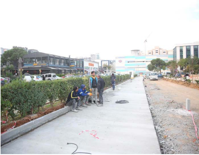
Kaşüstü Mahallesi'nde Trabzon Adliyesi önünde altyapı çalışmaları ve sonrasında çevre düzenlemesi gerçekleştirildi.
