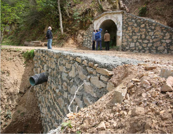
Tepeköy Mahallesi-Demirciler bağlantı yolu üzerinde istinat duvarları inşa edildi. Ayrıca bölgede bulunan tarihi çeşme etrafında çevre düzenlemesi yapıldı.
